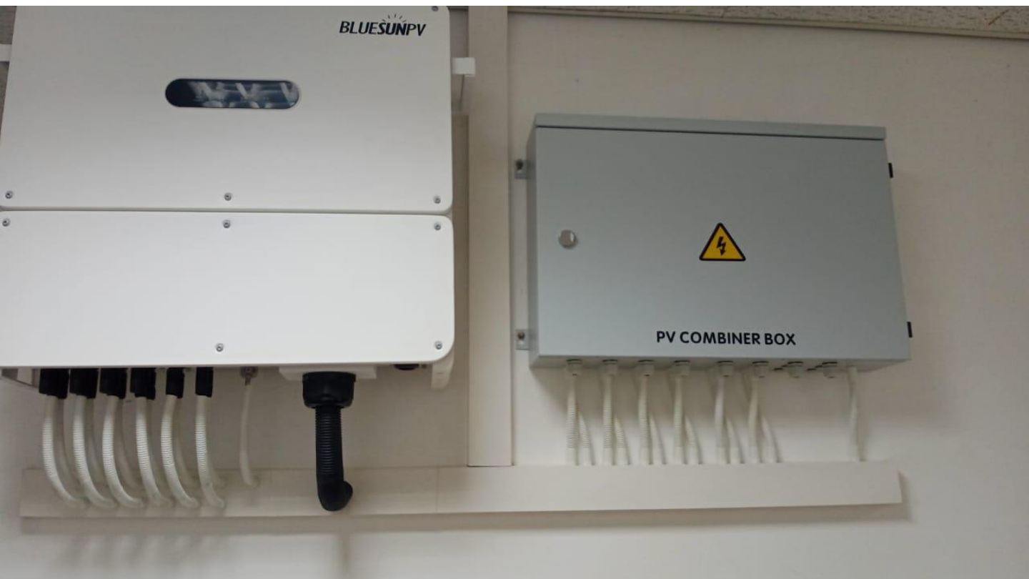
Rajah 8 gambar Inverter dan kotak PV Combiner
